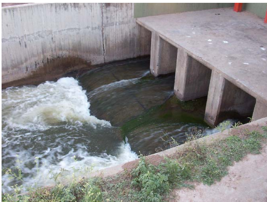
Foto 16. Compuerta del canal de riego Laguna Yema –Las Lomitas.
