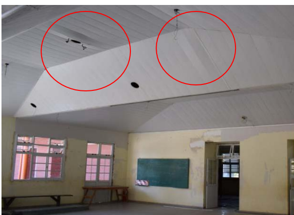
DEFORMACIÓN DE CIELORRASO POR ACUMULACIÓN DE AGUA
